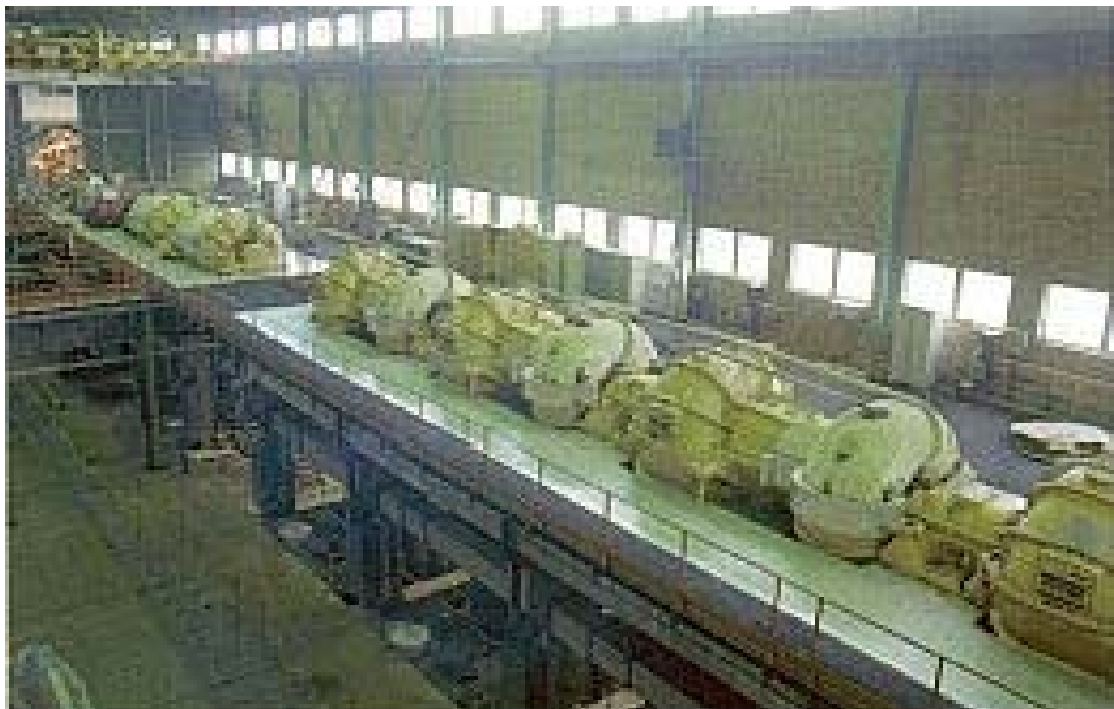
(b) Les deux lignes de compresseurs CA et CB
